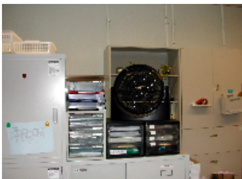
サーキュレーターで空気を攪拌 (隅々まで冷気が行き渡ります)
