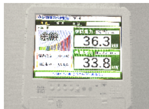
デマンド監視装置による電気使用量監視 (何回か警報鳴りました)
