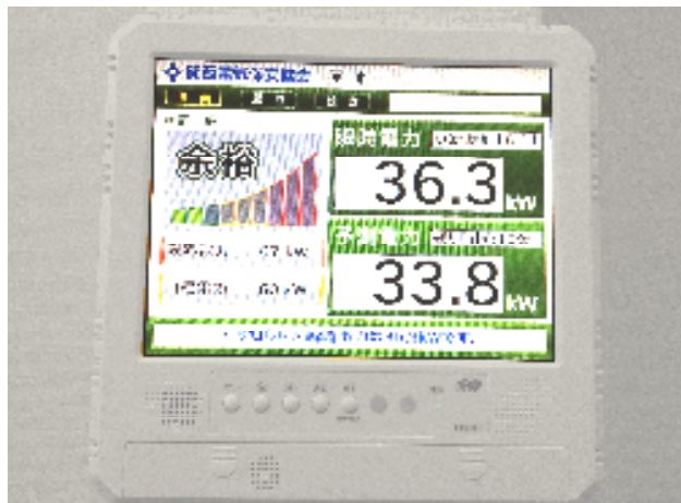
デマンド監視装置
